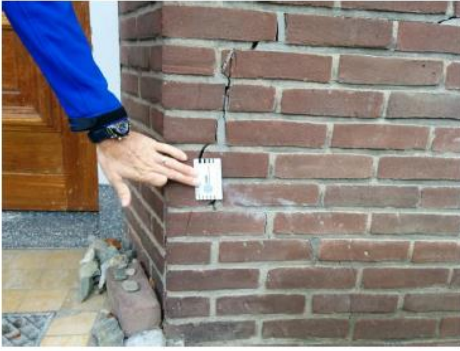
Scheurvorming in gevel kamer 2A zuidwestzijde.
