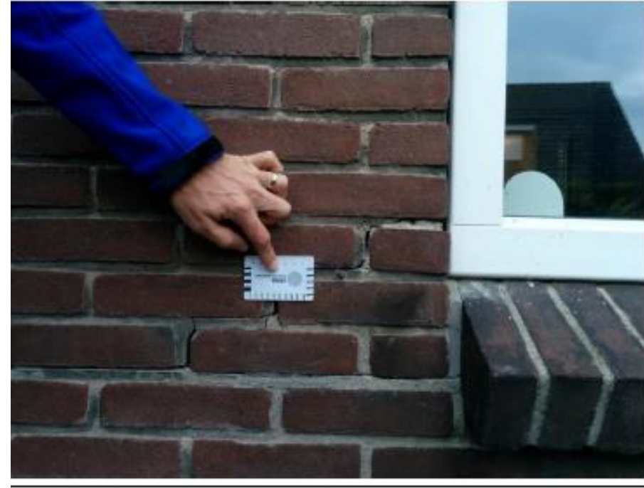
Scheurvorming in gevel kamer 2A zuidwestzijde.
