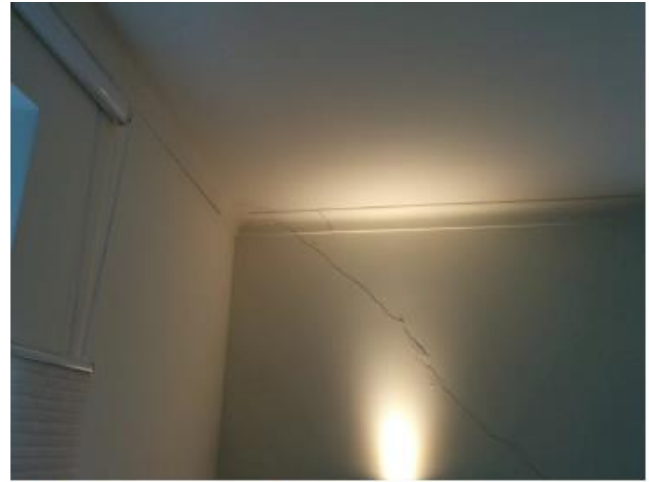
Scheurvorming in wand kamer 2A zuidwestzijde.
