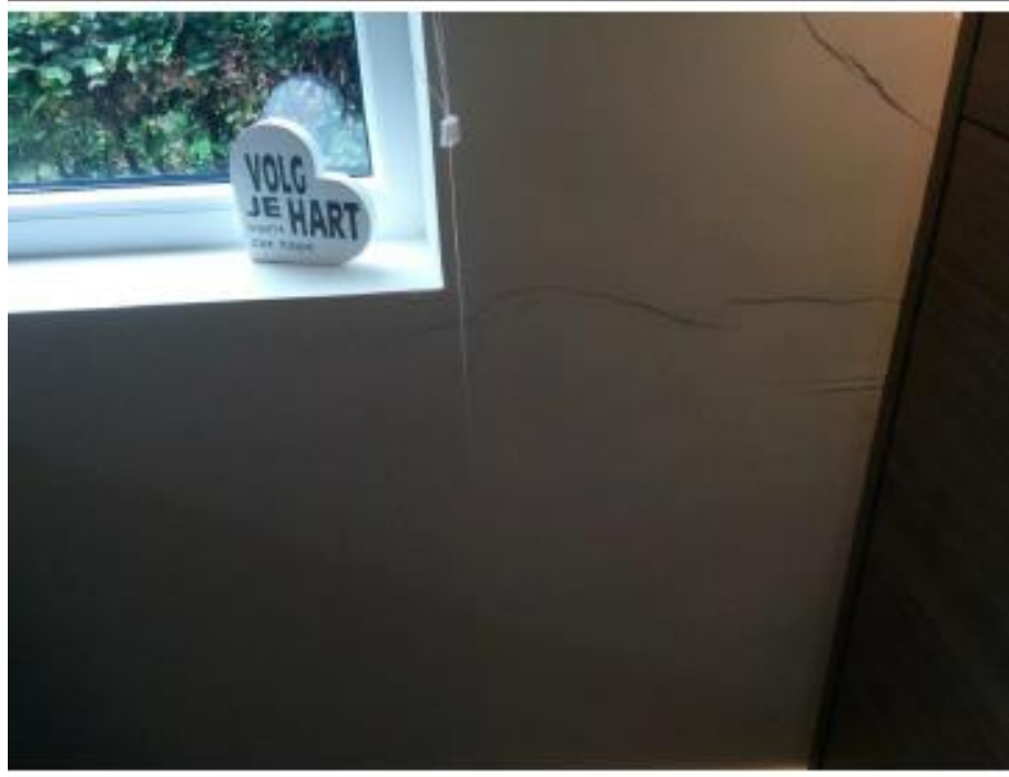
Scheurvorming in wand kamer 2A zuidwestzijde.
